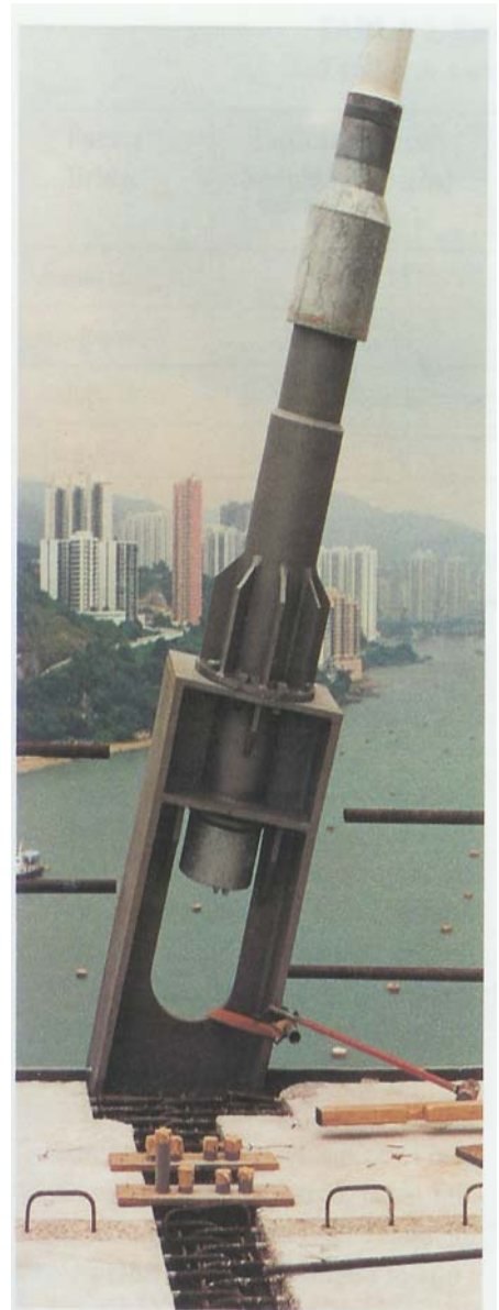
Figura 11. Anclajes de los cables en el tablero. Figure 11. Cable anchorages on the deck.
