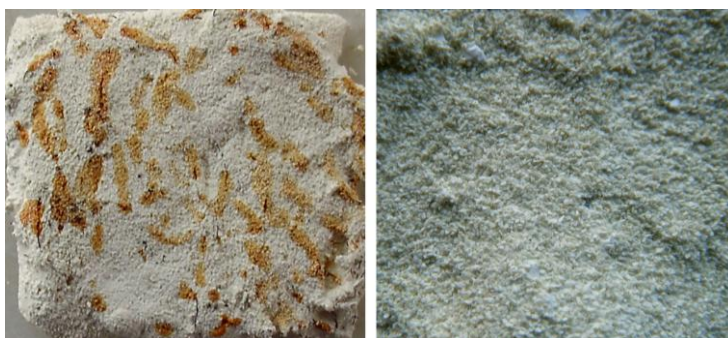
Figura III.72. Mancha de óxido debida a la fibra de acero (izquierda).
