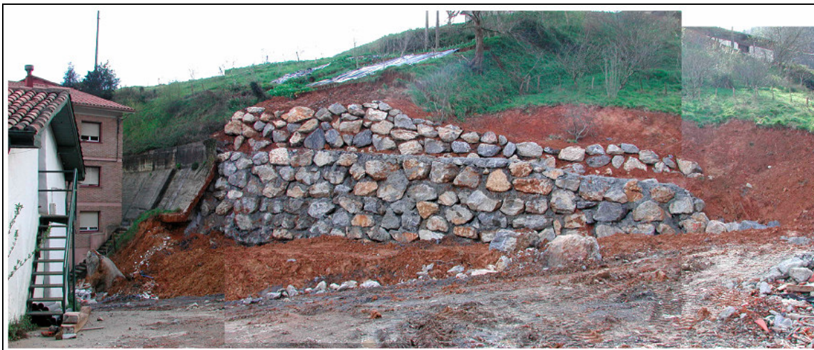
Figura 6.12. Escollera protegiendo un edificio afectado por un deslizamiento en el municipio de Mendaro.
