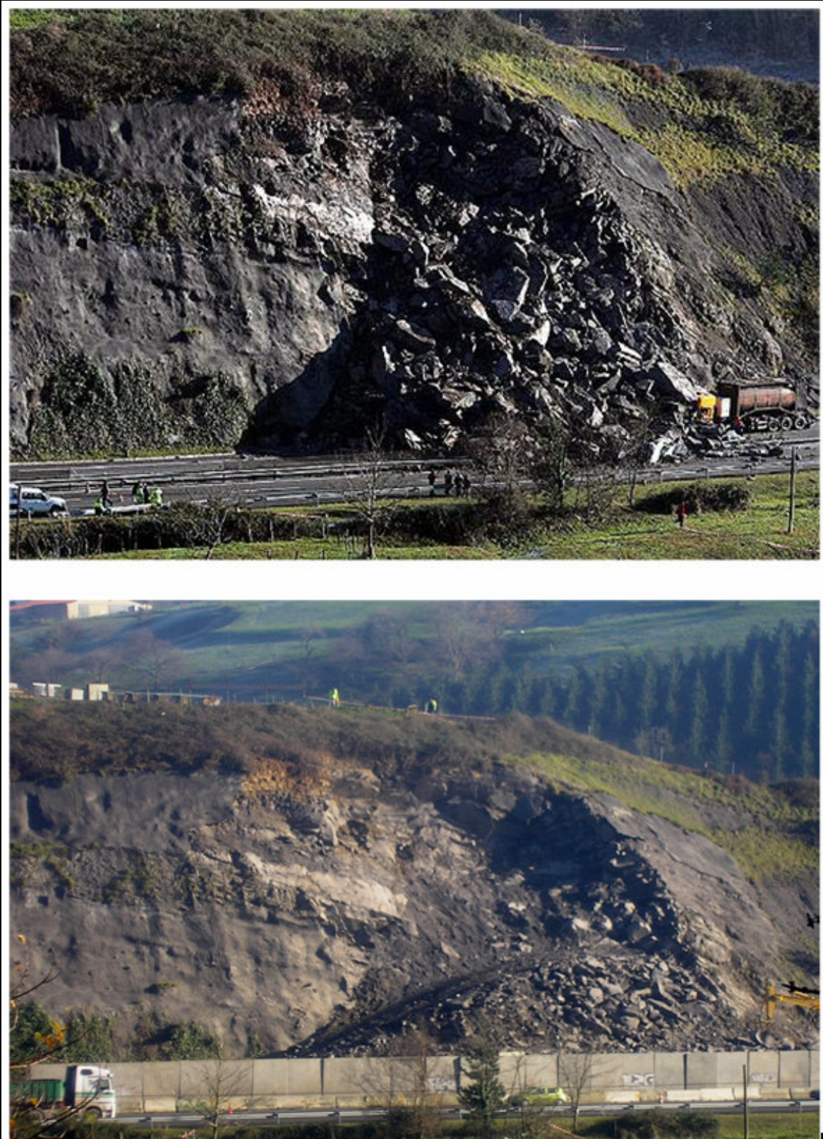
Figura 6.11. Detalles del deslizamiento que afectó a la autopista A-8 el 20 de diciembre de 2005, en el punto kilométrico 51,5 (sentido Bilbao). Dos coches y un camión fueron afectados directamente (arriba); labores de restauración (abajo). El carril sentido Bilbao quedó cortado durante día y medio.
