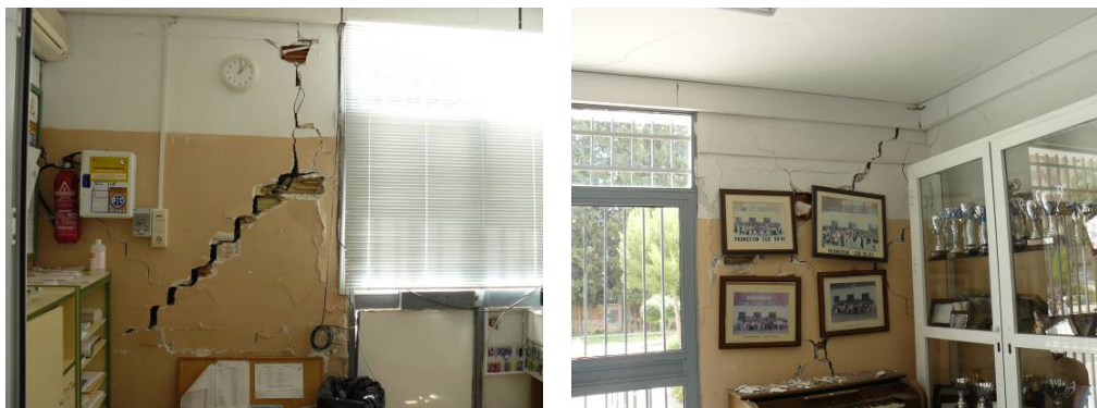
Foto C. 19 Fisuras diagonales en particiones y muros de fachada
