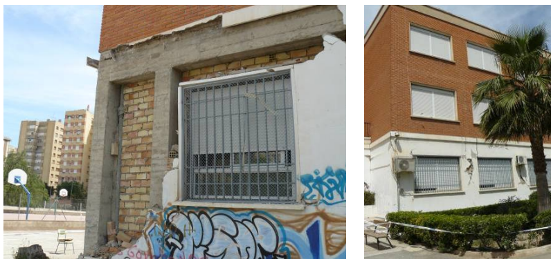
Foto C. 18 Caída del recubrimiento en muros de fachada
