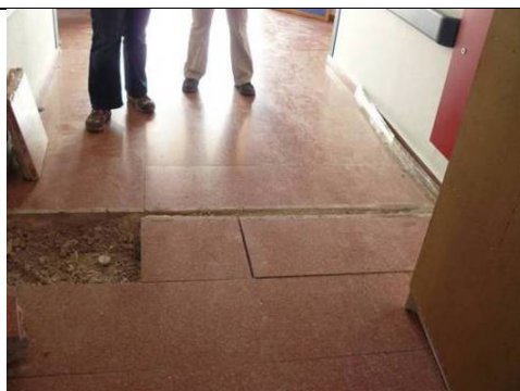
Foto C. 31 Desplazamientos de la junta de dilatación
