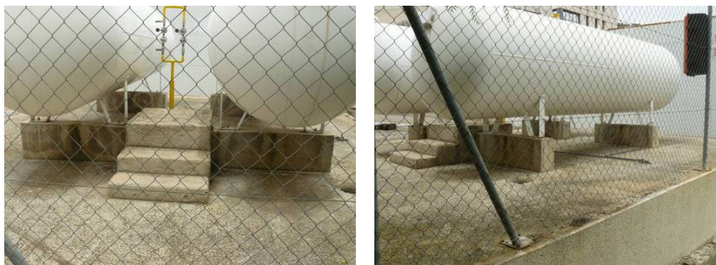
Foto C. 39 Conexión de los tanques de almacenamiento de gases
