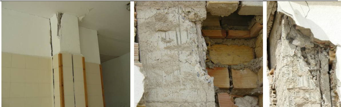
Foto C. 17 Fallas en pilares del edificio
