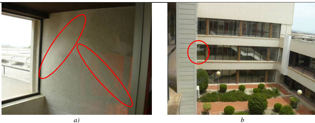
Foto C. 33 a) fisuras en muros de escalera, b) ruptura de ventanas
