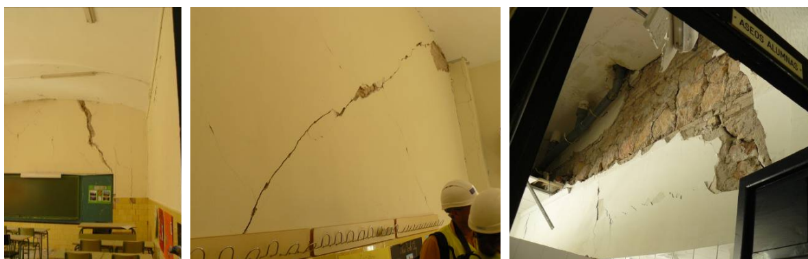
Foto C. 13 Agrietamientos diagonales en los muros de piedra
