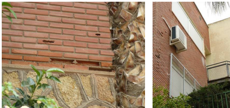
Foto C. 23 Falla de las unidades de mampostería y de los muros de fachada del CEIP Alfonso X el Sabio
