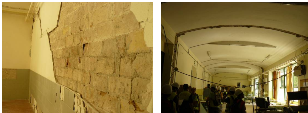
Foto C. 12 Fallas de las unidades de mampostería y fisuras diagonales en muros de división
