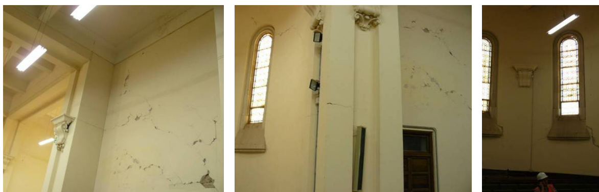
Foto C. 11 Fisuras en muros estructurales
