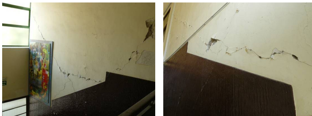
Foto C. 14 Agrietamientos en los muros de la escalera
