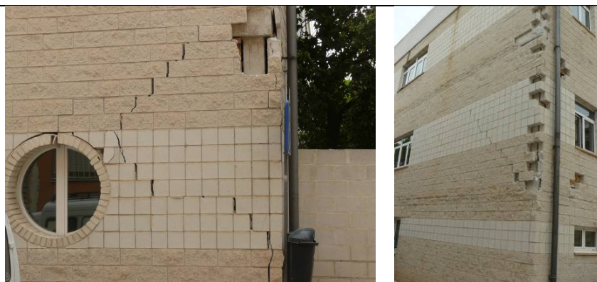
Foto C. 26 Daños en muros de fachada
