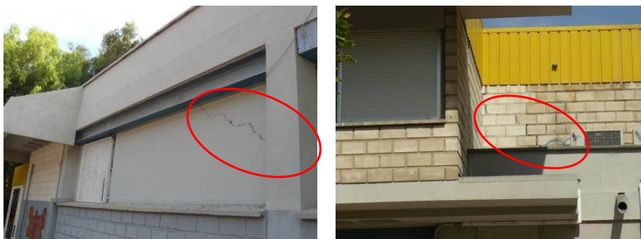
Foto C. 7 Daños en muros de fachada
