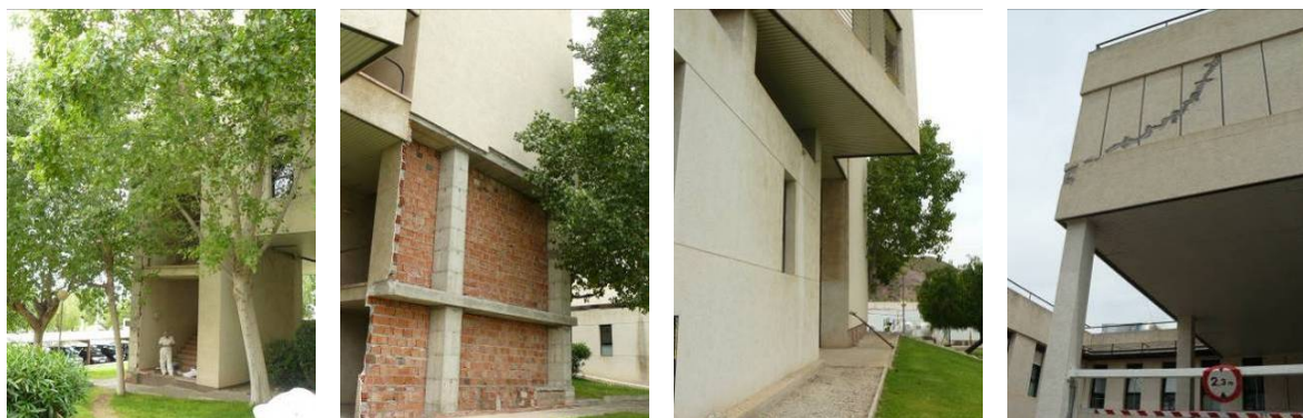
Foto C. 32 Colapso de muros de fachadas y recubrimientos de fachadas
