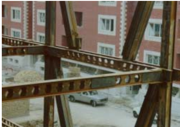
Figura A 13 Ejemplo de un detalle de una estructura metálica con riostras excéntricas
