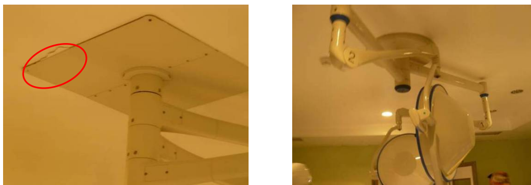
Foto C. 37 Conexión del equipo médico en los quirófanos
