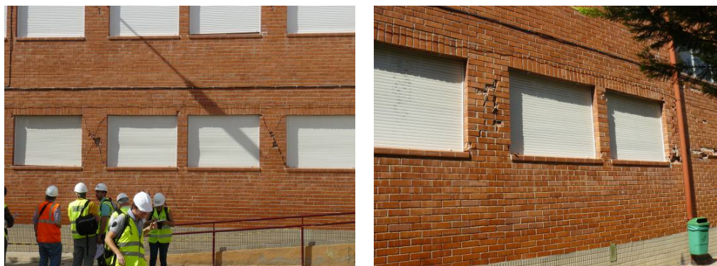
Foto C. 9 Fisuras diagonales de los muros de las fachadas
