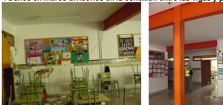
Foto C. 5 Grietas diagonales en muros divisorios
