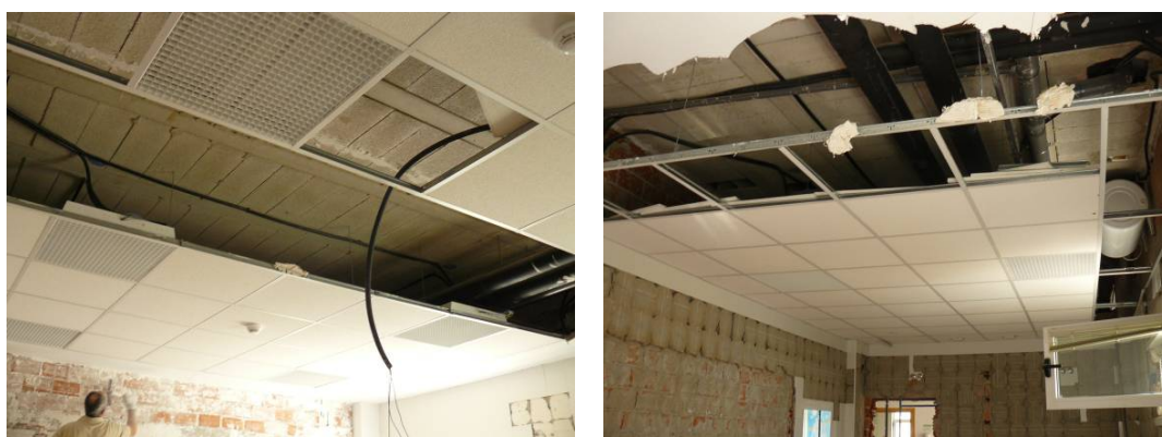
Foto C. 28 Caída de falsos techos
