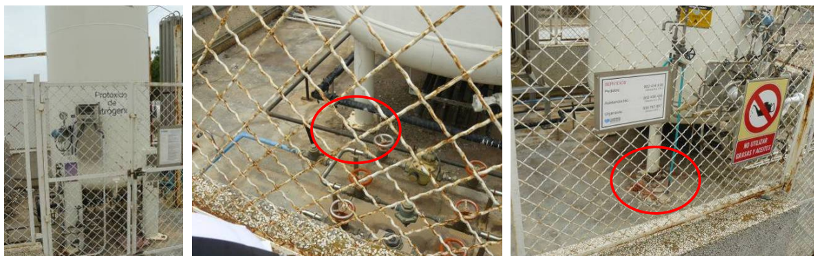
Foto C. 40 Detalle de conexión de tanques de almacenamiento
