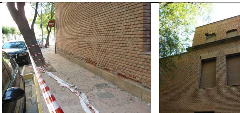
Foto C. 24 Falla de las unidades de mampostería y de los muros de fachada del IES Ramón Arcas Meca
