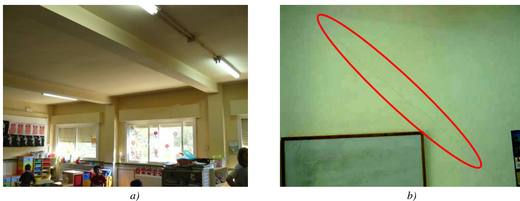
Foto C. 2 Jardín infantil Muñoz Barberán. a) Pilares, vigas y muros de relleno sin daños visibles. b) leves fisuras en muros divisorios
