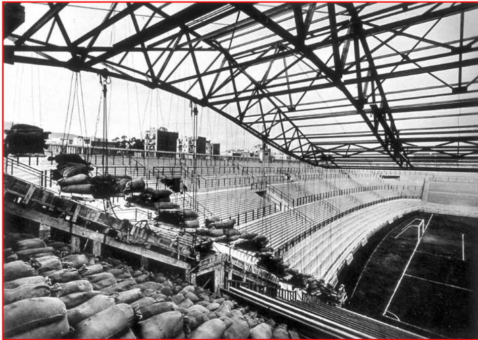
Figura 2.38 ETM-284. Tribuna cubierta del Campo de fútbol de Les Corts. Barcelona. Font: Archivo Torroja.
