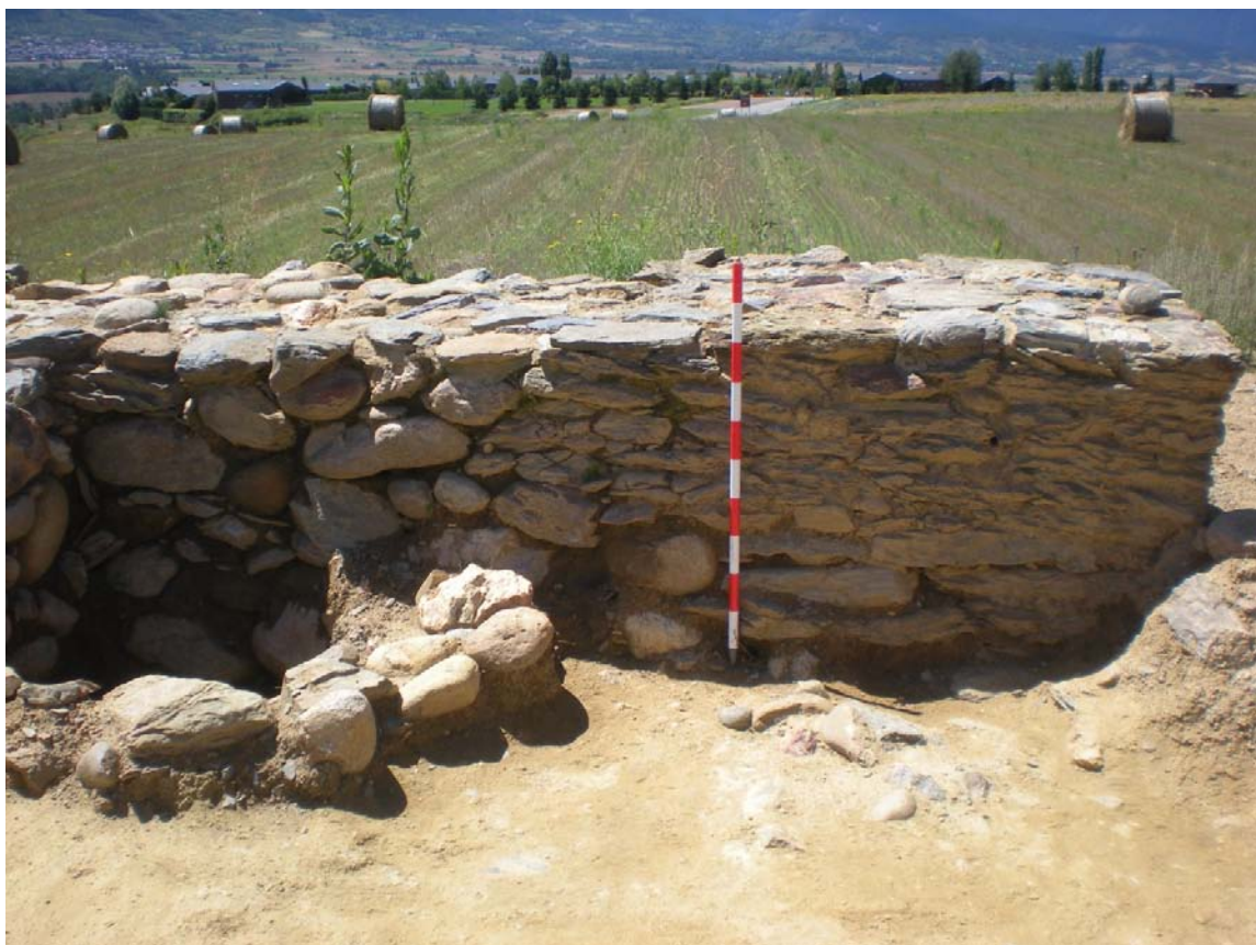
Vista del clos des de l'àmbit VII on s'observa el parament de la torre, a la dreta, totalment diferent del de la muralla, a l'esquerra
