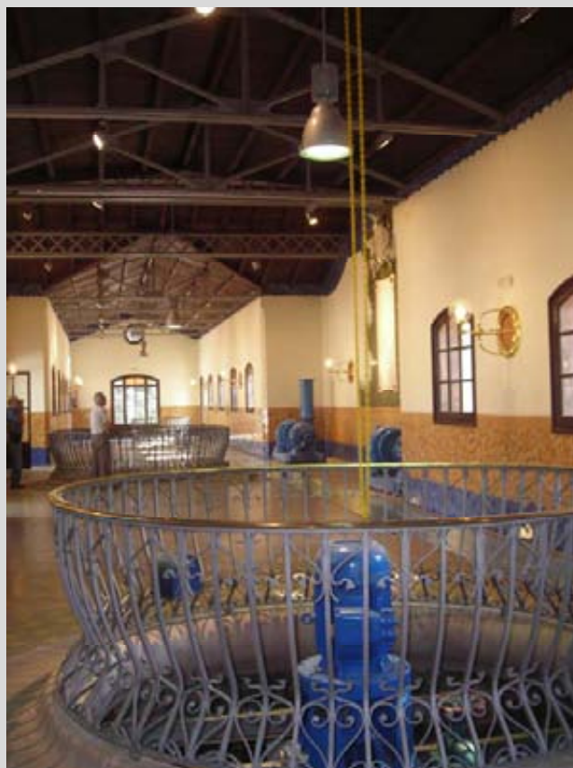
IMATGE 10 SALA DE POUS DE LES INSTAL·LACIONS MUNICIPALS DE MONTCADA 45
