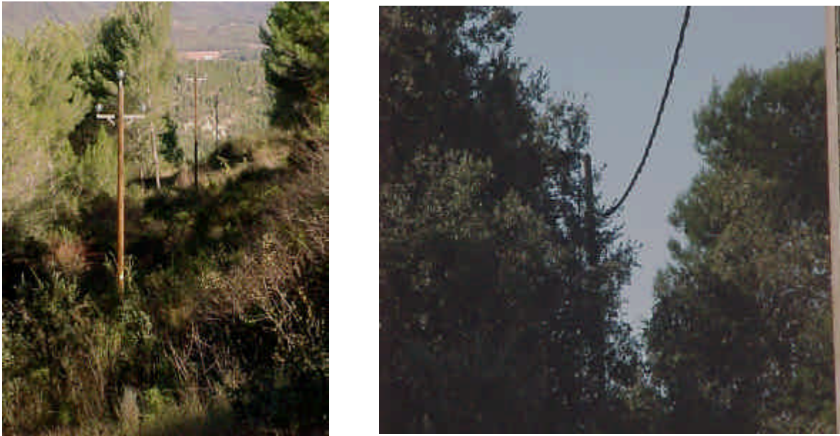
Figura 20: Línia amb sistema de fils convencionals i cable trenat molt més segur
