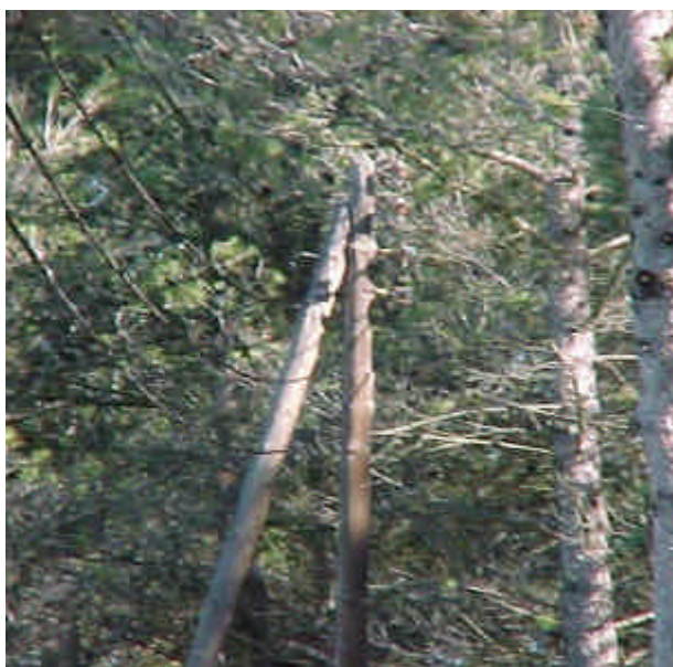
Figura 19: Línia elèctrica que presenta un risc important
