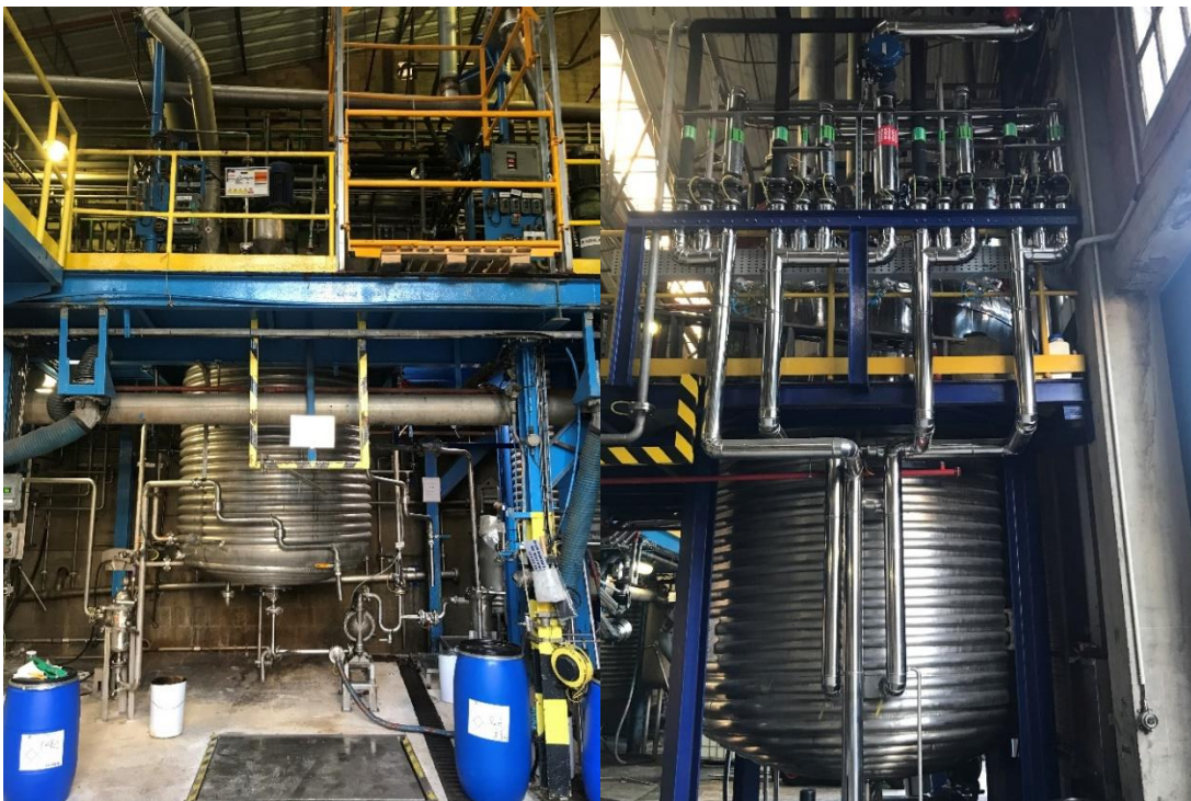
Figura 44. Fotografies de la instal·lació utilitzada de la planta industrial de Cromogenia Units.
