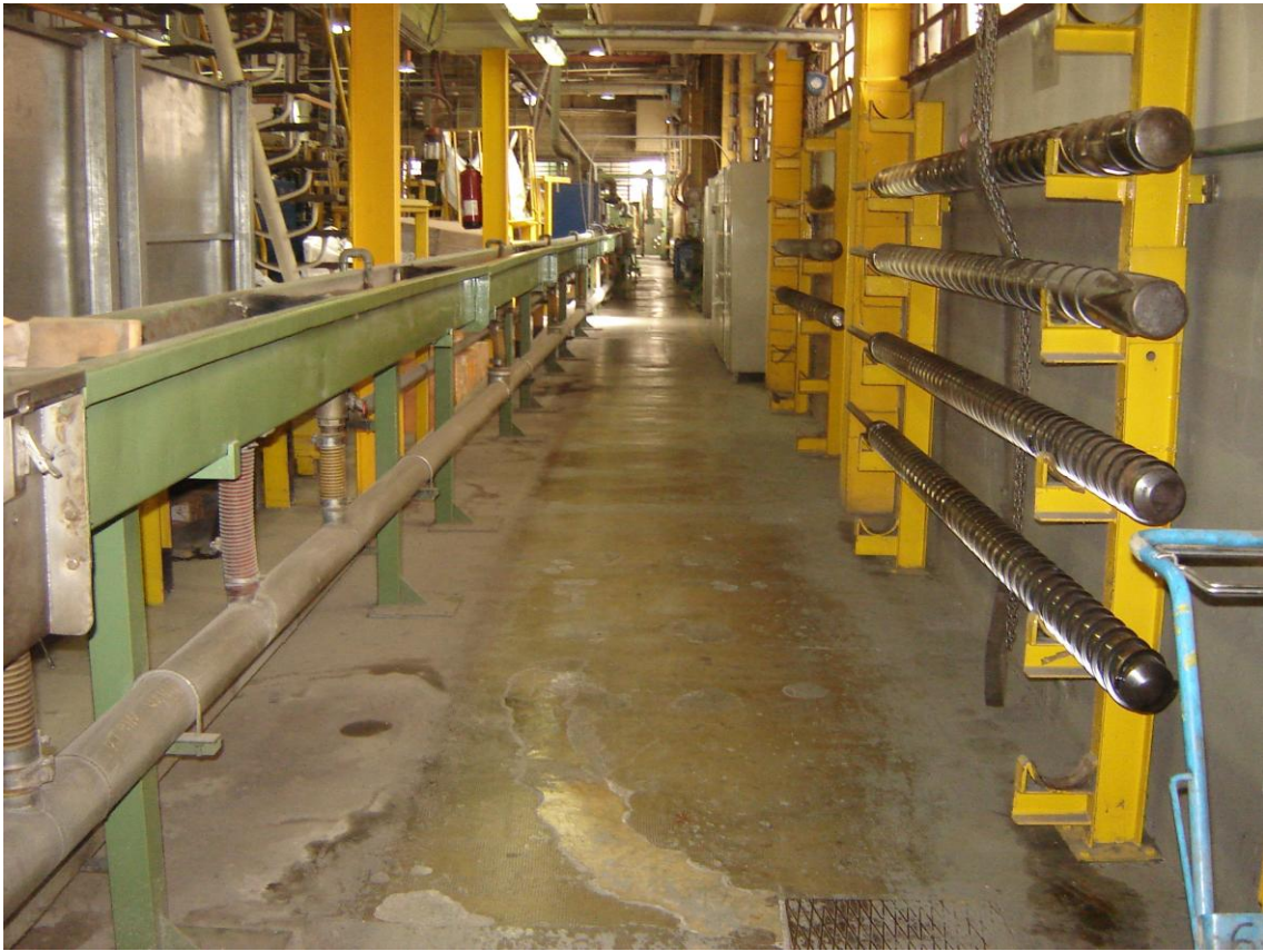
Barques de refrigeració i bisenfans d'extrusora de plàstic.
