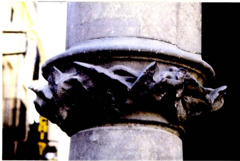
Foto 5 Detall d'un capitell de les cinc columnes de la porxada de la planta baixa a la façana principal, amb decoració vegetal.
