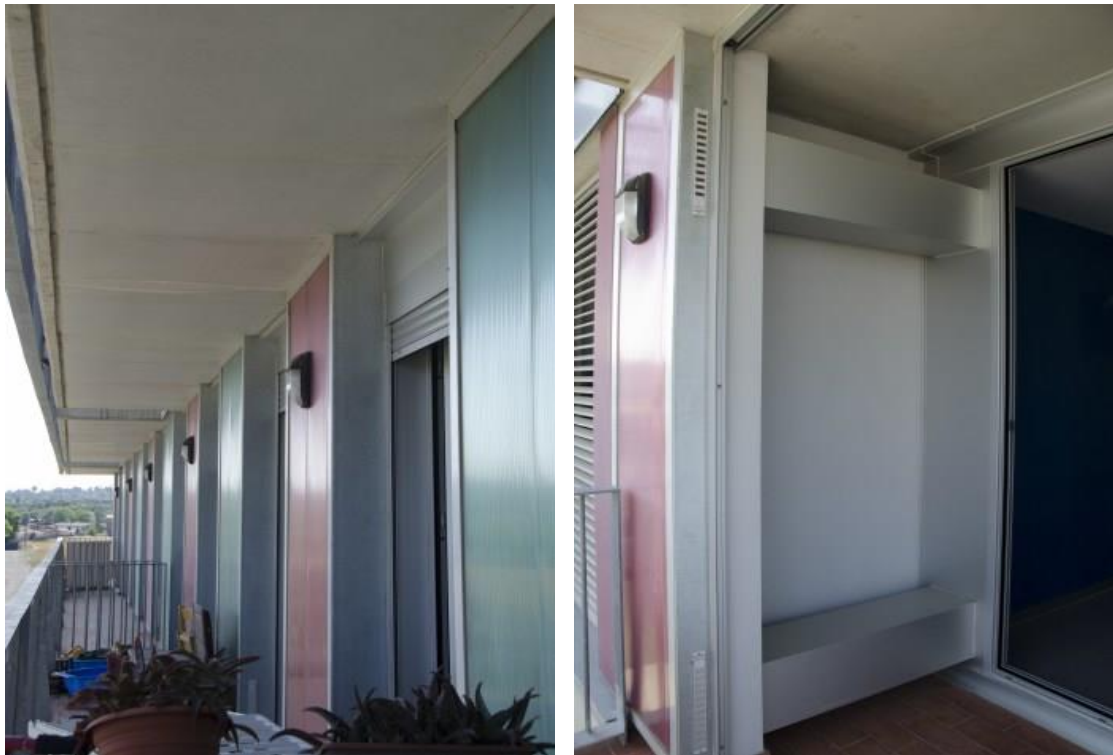
Figura 6. Fotos del muro Trombe. Fuente: https://ecobiohabitat.com
