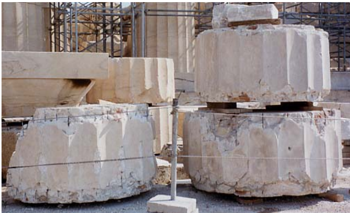
(Fig. 3) Presencia de deterioros en las piezas que habían sido intervenidas con hormigón armado en el Partenón en los años treinta.
