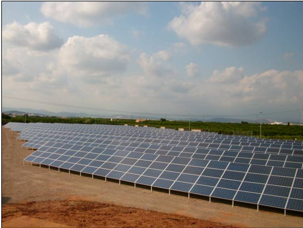
Figura II.10.1.1. Vista del huerto solar de Vila-real
