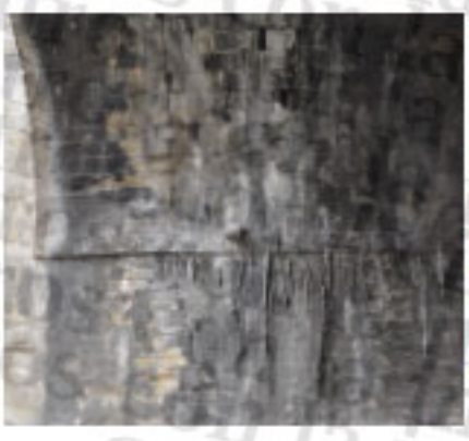
(337) Humedades bajo arco en South Bridge, Edimburgo, 2019. (338) Grafitis sobre fachadas del cajón de Santis, Barcelona 2018.
