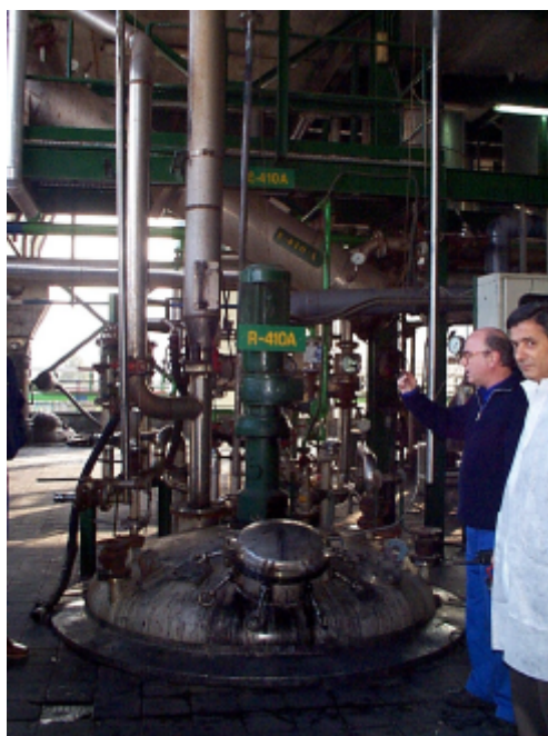
Figura 5.6. Reactor R-410-A con una capacidad de 10 m 3 de la empresa Clariant S.A.
