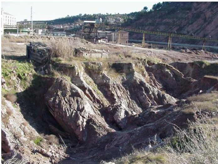
Figura núm. 51. L'esvoranc que ha quedat finalment a la llera del riu Cardener té unes dimensions de més de 7 metres de profunditat per 200 metres de llargària i 30 d'amplada. Els límits longitudinals a la llera del Cardener anaven des de sota de la cinta transportadora fins a trobar les margues suprasalines, és a dir, tota l'amplada del diapi
