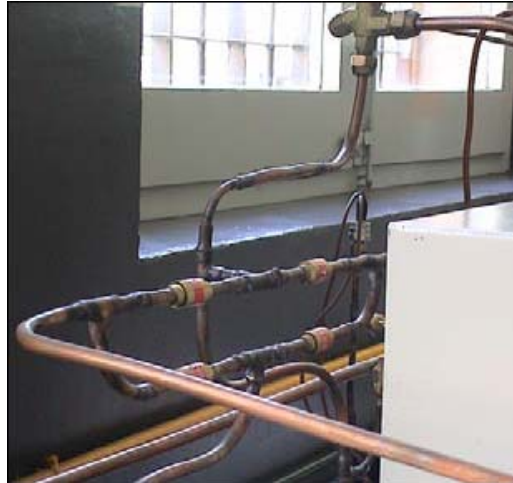
Fotografia 3.21. Vàlvules de retenció situades en el bypass del dipòsit d'anticop de líquid
