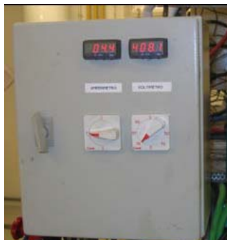
Fotografia 3.28. Quadre elèctric amb amperímetre i voltímetre
