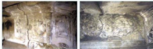
La Rambla, 129 Roturas del soporte consecuencia de la instalación
