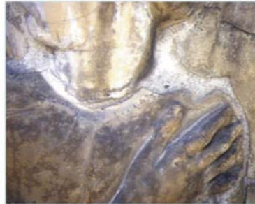
C/Hospital, 83 Piezas rotas antes de su instalación
