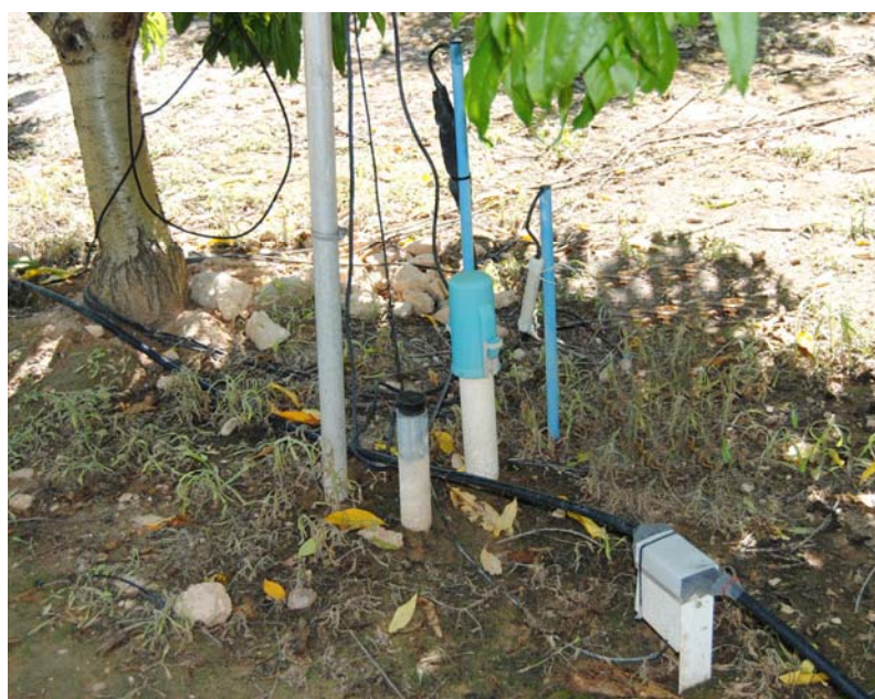
Fotografía 6. 1. Disposición del tubo de acceso de sonda de neutrones, sondas Watermark® (tubos finos azules), sondas capacitivas Cprobe™ (tubos blancos de PVC) y caudalímetro.
