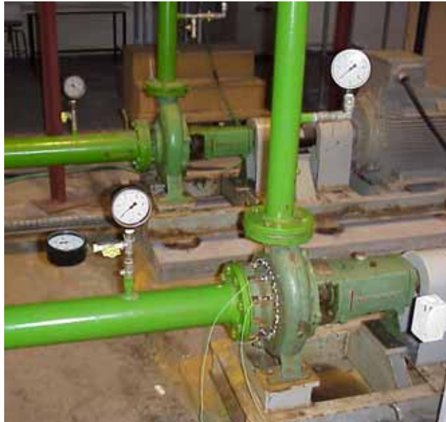
Fig. 4-7. Detalle de las bancadas de las bombas y sus interconexiones con el resto del circuito.
