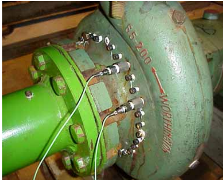
Fig. 4-17. Conexión de transductores a la voluta de la bomba.
