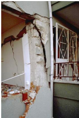
(a) Fallo de columna en edificación (Izmit, sismo en Turquía 1999)
