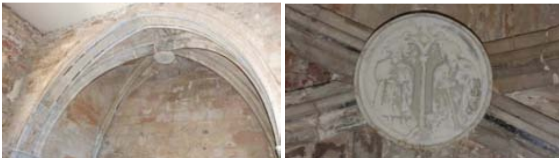
Fig. 71 a i b.: Església de l'hospital de Benavarri. Capella de santa Helena (abans sant Joan). Detall de la clau de volta.
