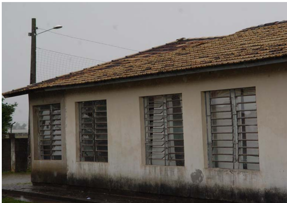
Foto 15 - Escola Básica Noé Abadi. Parede externa.
