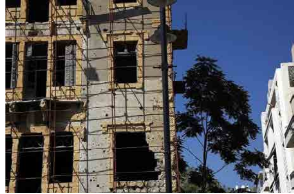
Figura 3.2: Barkat Hous, edificio residencial localizado también en la 'green line'. Edificio fue ocupado por milicias debido a su posición estratégica, la fachada las marcas de balas. Foto en el inicio de la restauración en 2011.
