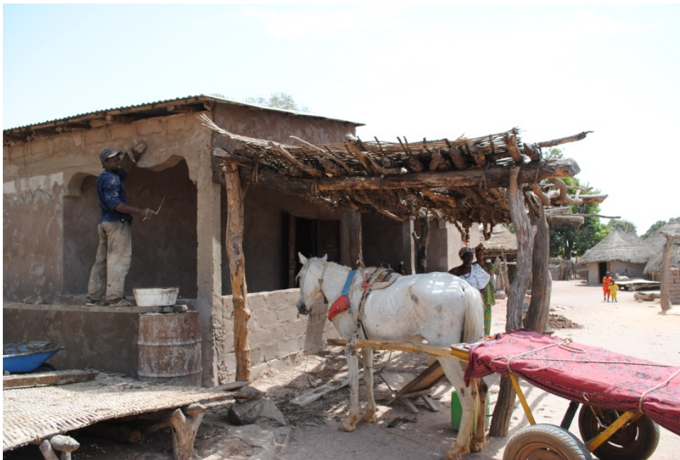
Imatge 12. Casa en construcció finançada per un emigrat a una petita localitat del Fuladú. Foto: Ariadna Solé
