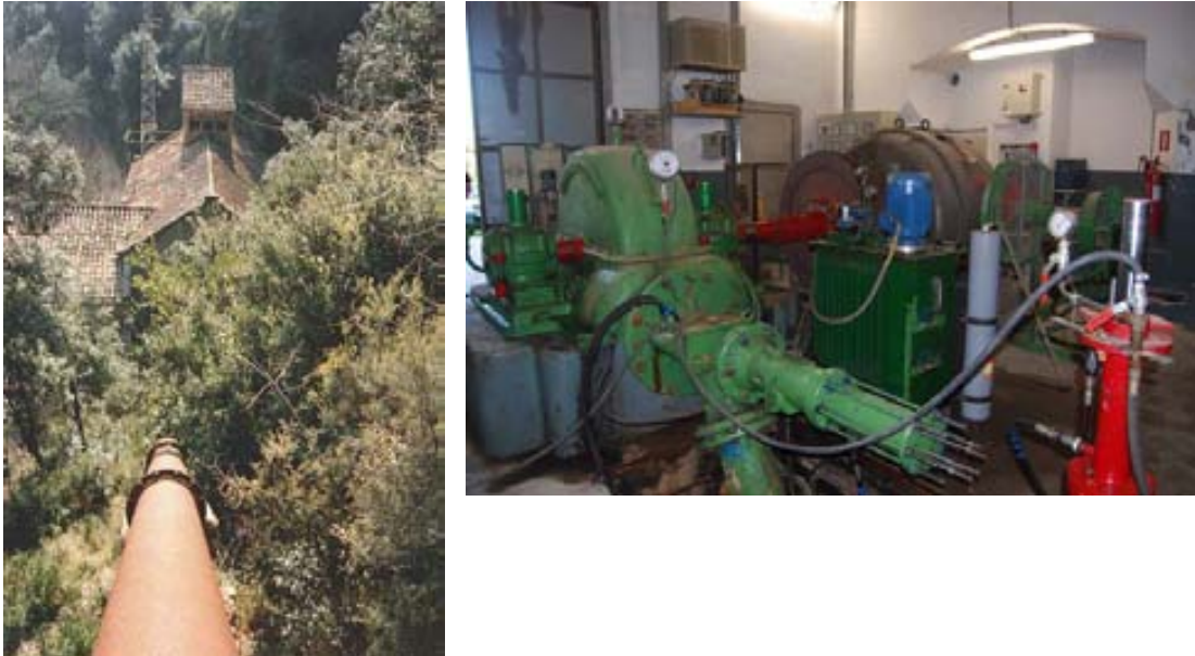
Figura 6.15. A l'esquerra, vista superior de la central de Dalt. A la dreta, turbina i alternador a l'interior de la Central de Dalt.
