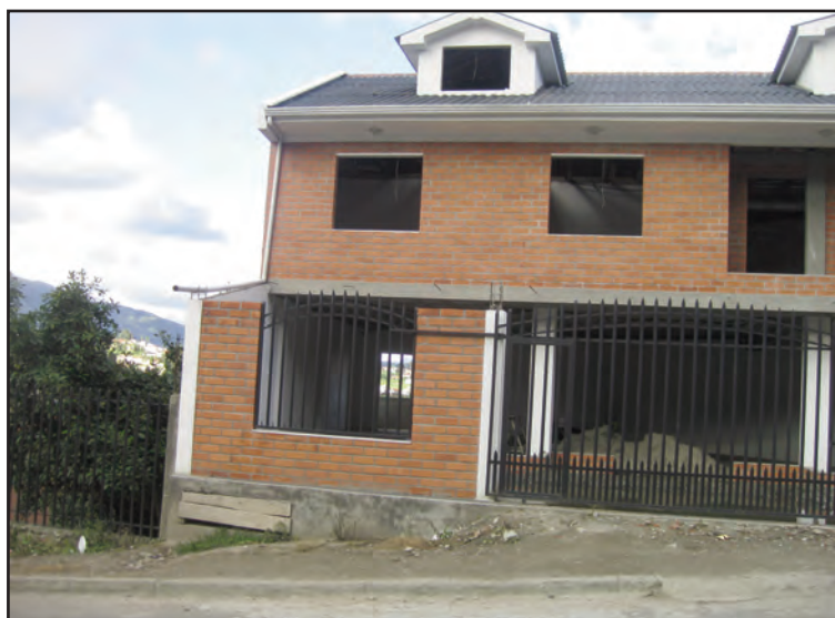
Fotografía 5.25. Casa en construcción propiedad de ecuatorianos en España, marzo 2011. Cercanías de la ciudad de Cuenca, Azuay.
