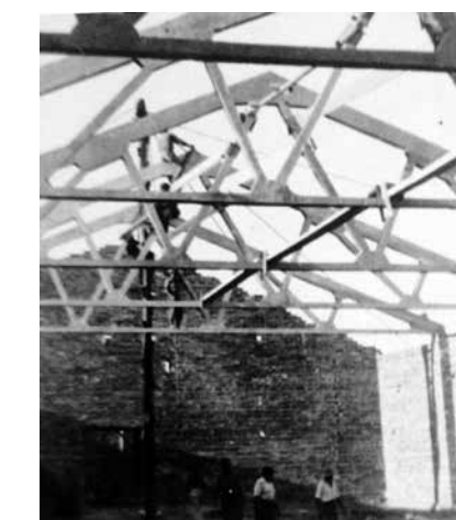
44 Construcció de la nau per a panificació a Balaguer realitzada pels constructors Profitós.
