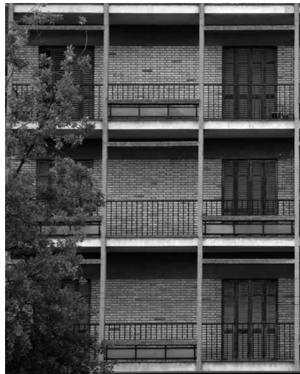
32 Imatge actual de la malla de formigó superposada a la façana tradicional d'obra ceràmica vista
