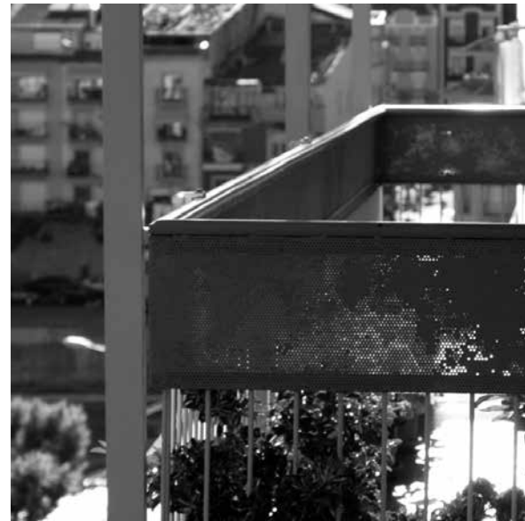
18 Imatge actual de la barana de l'edifici Almatà. Passamà de xapa metàl·lica perforada
