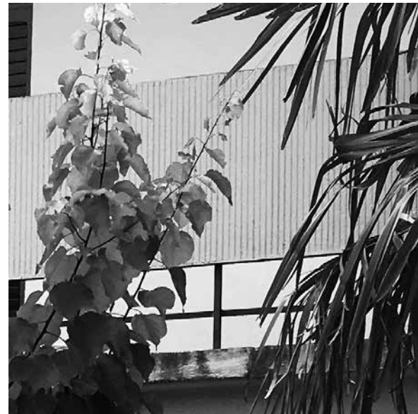
20 Imatge actual de la barana a la casa en cantonada al grup del carrer Cadí. Panell de formigó ondulat
