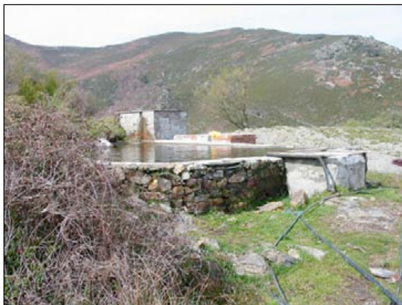
Foto 6. Sistema de almacenaje y distribución del agua.
