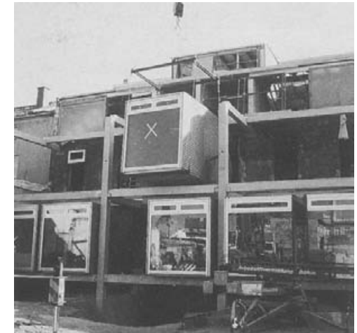
Transporte, izado y montaje de módulos tridimensionales ligeros en la ampliación de un edificio histórico en Rathenow, Alemania.
