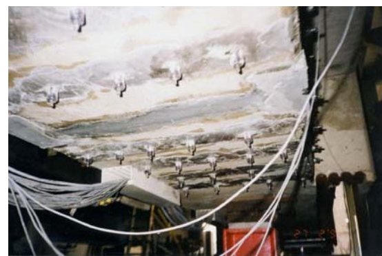
Fotografía 4.36 Vista inferior de los inyectores, fisuras selladas y rehormigonado.
