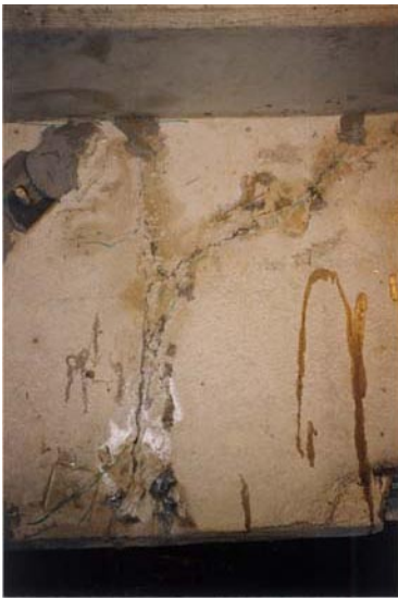
Fotografía 4.3 Fisuración en sección centro-luz vano cargado
