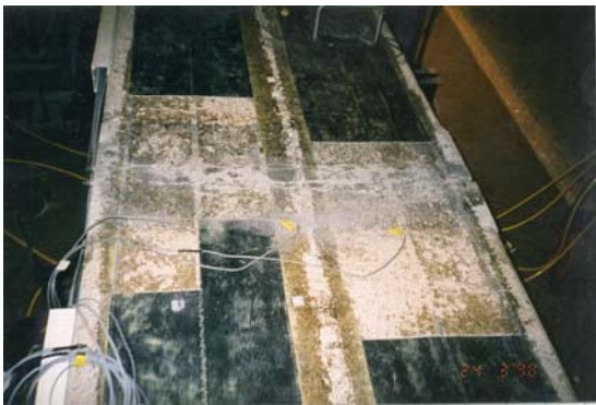
Fotografía 4.49 Vista de la sección de apoyo central después de quitar las fibras dañadas.
