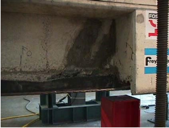
Fotografía 4.66 Vista del desprendimiento del hormigón en desviador.
