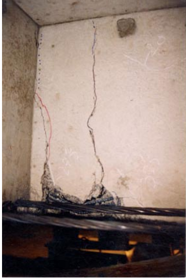
Fotografía 4.9 Fisuración en desviador 1 de la sección centro-luz vano cargado
