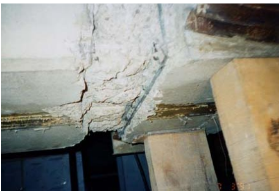
Fotografía 4.15 Vista inferior del vano cargado. La armadura longitudinal se ha cortado.
