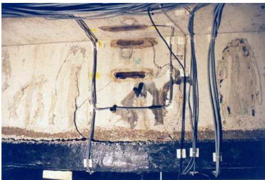
Fotografía 4.42 Vista de la sección centro luz del vano 1 después del ensayo.
