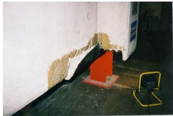
Fotografía 4.50 Vista de zona de desviador a sanear. (vano 2)
