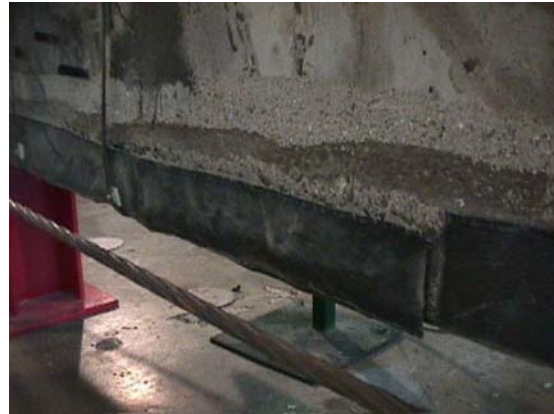
Fotografía 4.63 Vista final del estado de las bandas de TFC en vano 1 tras el ensayo.
