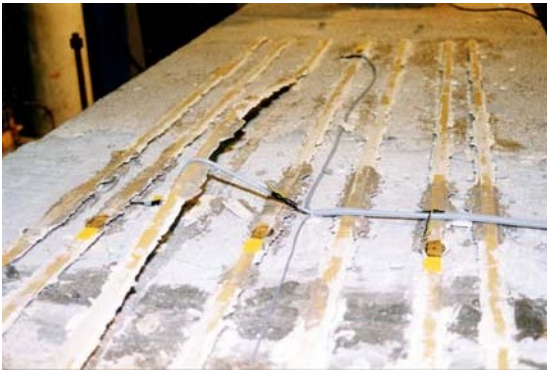
Fotografía 4.23 Vista del estado final de las fibras en apoyo central
