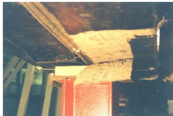
Fotografía 4.43 Vista de la rotura de la fibra de carbono en vano 1.
