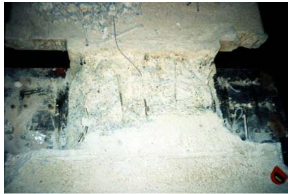
Fotografía 4.16 Apoyo central. Se han retirado el hormigón dañado y acero pasivo
