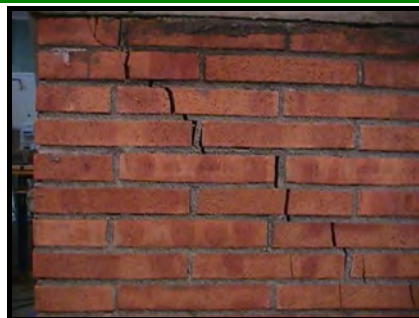
Rotura de piezas (tracción indirecta)
