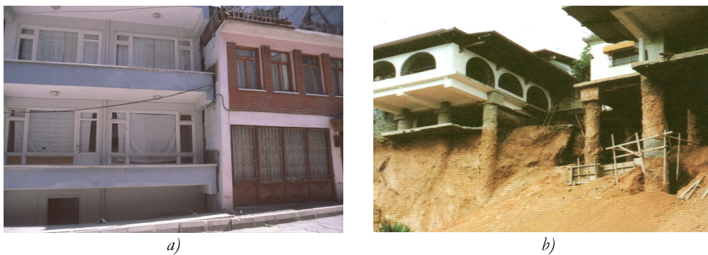
Figura 5.4. Condiciones del suelo: a) Licuación del suelo; b) Deslizamientos del suelo
