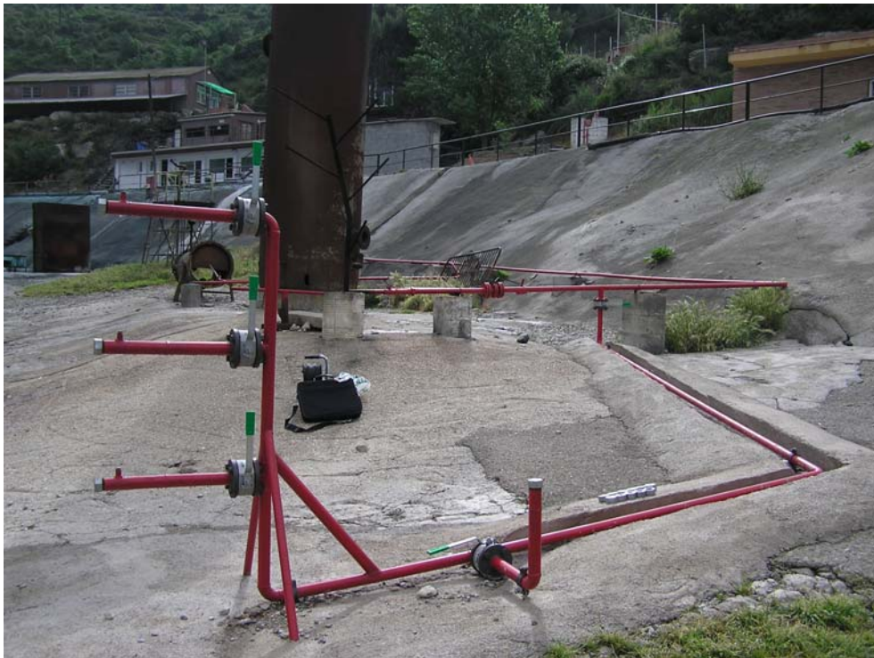
Figura 3.4 Fotografía de las tuberías de salida de la instalación.
