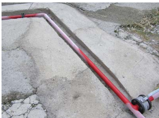
Figura 3.16 Tubería parcialmente recubierta de escarcha después de una prueba.
