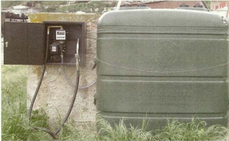
Figura 3.7. Depósito de combustible.
