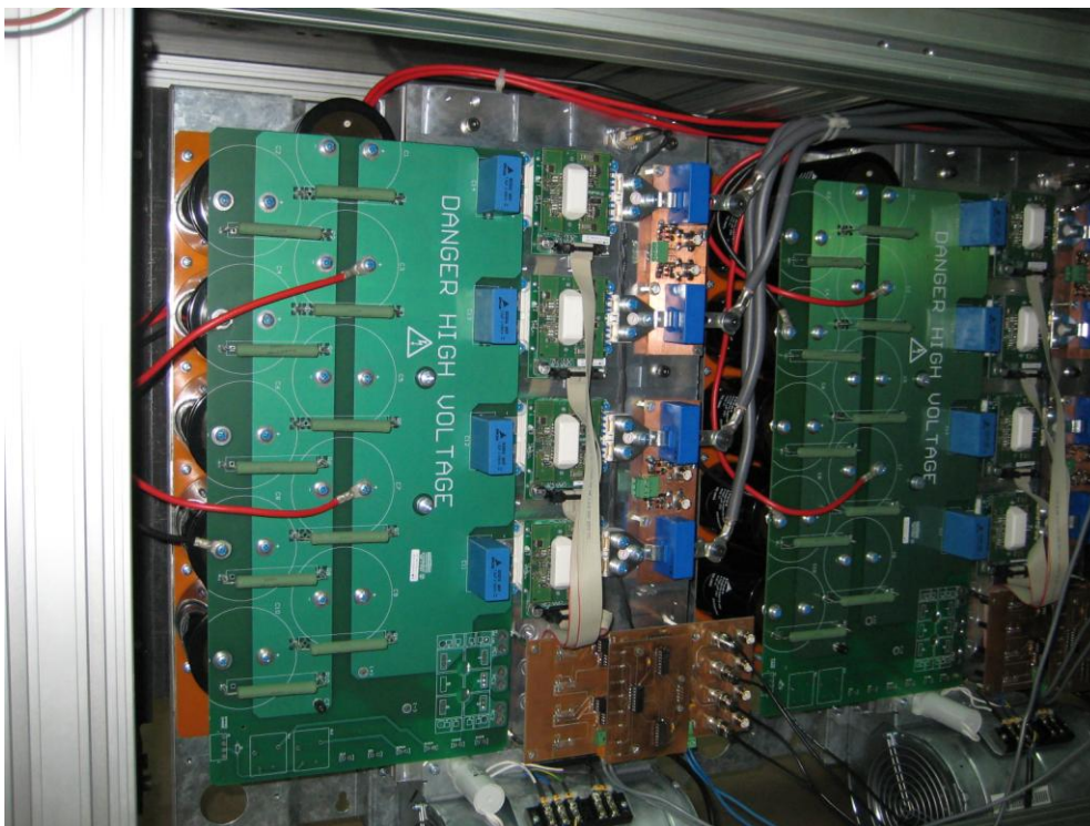
Figura AII.9: Convertidor de potencia y control.
