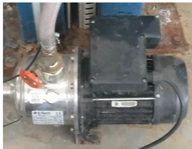
Figura 45: Foto en detalle de la bomba (2) donde se encuentra la válvula que regula el caudal (7).
