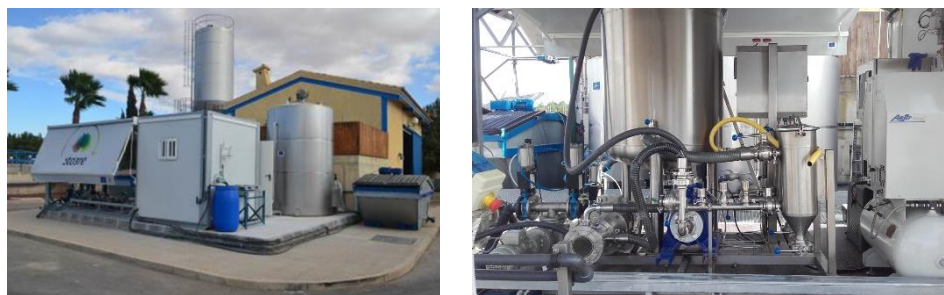
Figura 123: Planta piloto STO3RE situada en la EDAR de Totana (Murcia).
