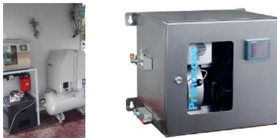
Figura 129: Sistema de ozonización utilizado en la planta piloto.
