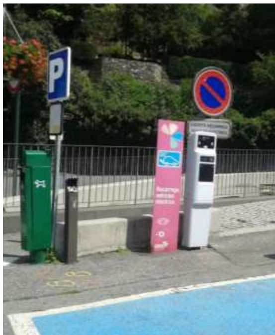
Figura 10. Punto recarga de coches eléctricos en un aparcamiento de Ordino en agosto del 2017
