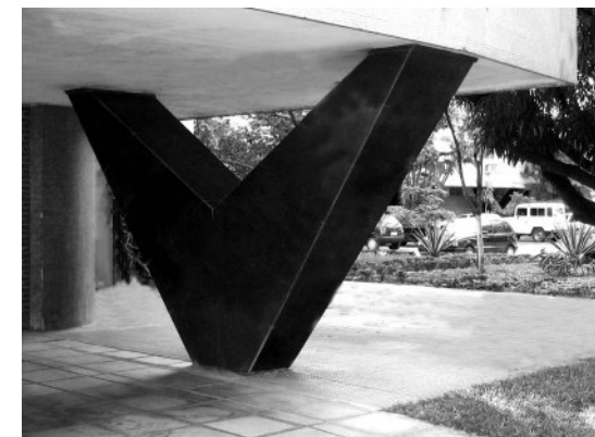
6.81. Detalle del pilar en "V" del edificio del DNOCS, proyecto del arquitecto Waldecir Pinto y equipo.
