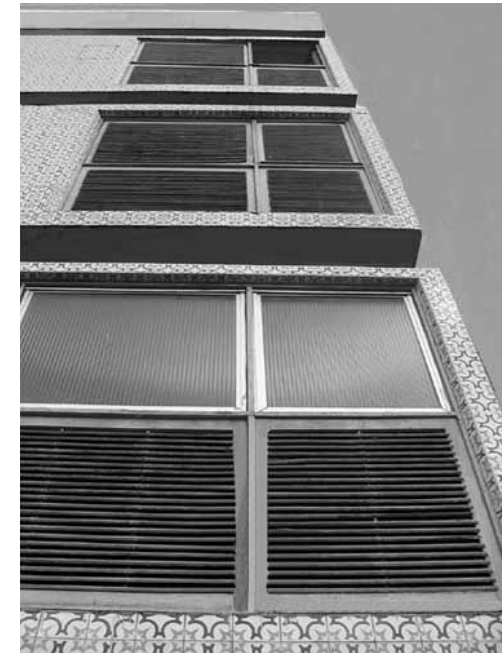
A.4.3.99. Detalle fachada principal: observar aperturas entre las losas.
