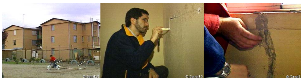
Ilustración 12 : Viviendas de deficiente calidad constructiva, denominadas casas "COPEVA", Chile [2005] 59
