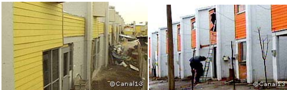
Ilustración 13: Viviendas entregadas sin recepción definitiva, afectadas por lluvias en temporales 60
