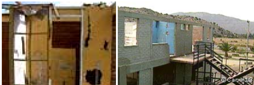
Ilustración 15 : Irreversible estado de conservación de viviendas sociales de la década de los 90 62
