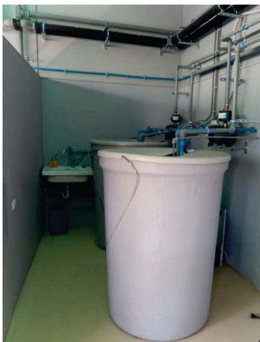
Figura 6.4: Acumuladores de agua caliente
