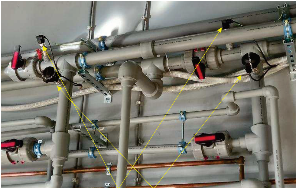
Figura 6.7: Dispositivos de presión y temperatura en Circuitos 1 y 2, respectivamente
