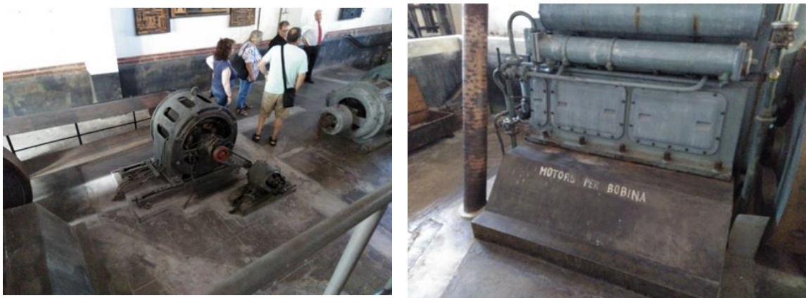
Figura 34: Máquinas eléctricas. Fotos de elaboración propia tomadas durante la visita a Codorníu
