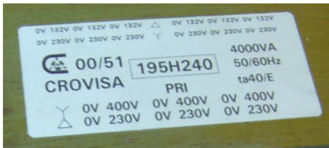
Figura CII.40.- Placa de características del transformador de laboratorio.
