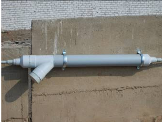
Foto 55 Vista de filtro colocado en el sistema de conducción
