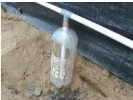
Foto 46 Válvula de seguridad.
