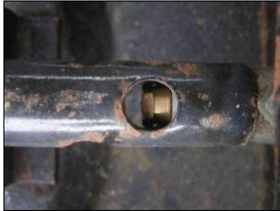
Foto 56 Vista del niple de una cocina de GLP
