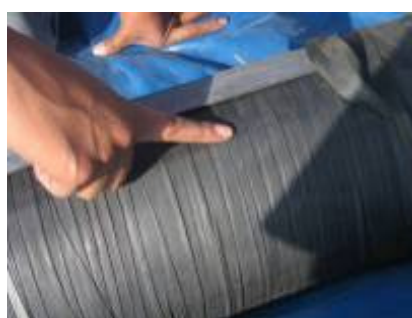
Foto 37 Jebe colocado correctamente
