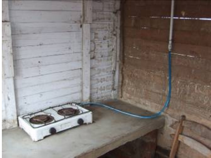
Foto 58 Detalle de la cocina conectada al sistema de conducción
