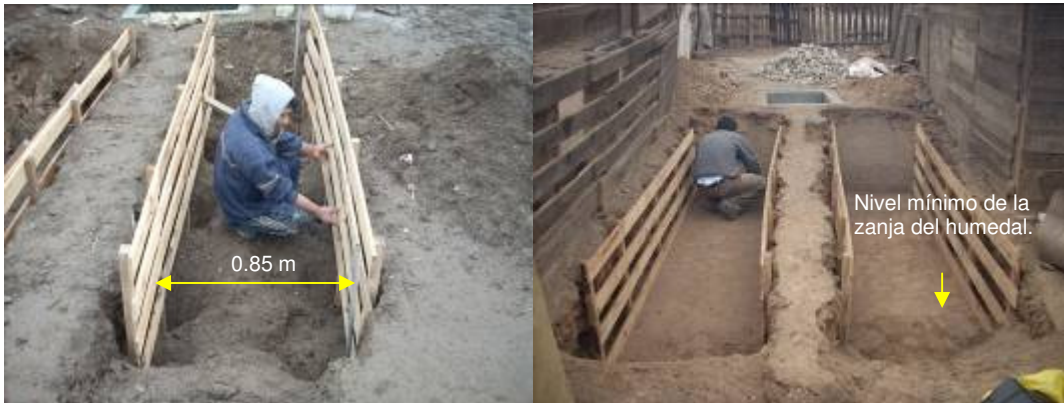
Foto 63 y Foto 64 Instalación de los refuerzos laterales y nivelación manual de la zona de salida.
