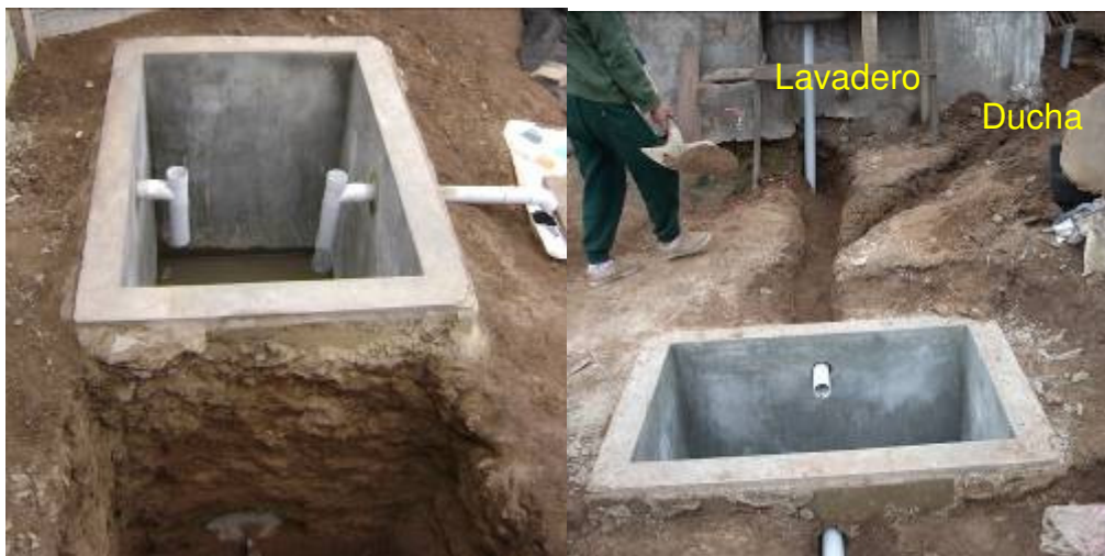
Foto 72 y Foto 73 Vista lateral del tanque de sedimentación y vista típica de las instalaciones sanitarias.
