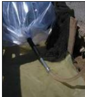
Foto 51 Manguera flexible a la entrada del reservorio de biogás
