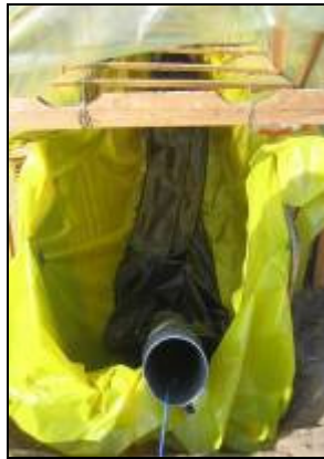
Foto 41 Manga instalada en la zanja con tubo de entrada mirando hacia fuera
