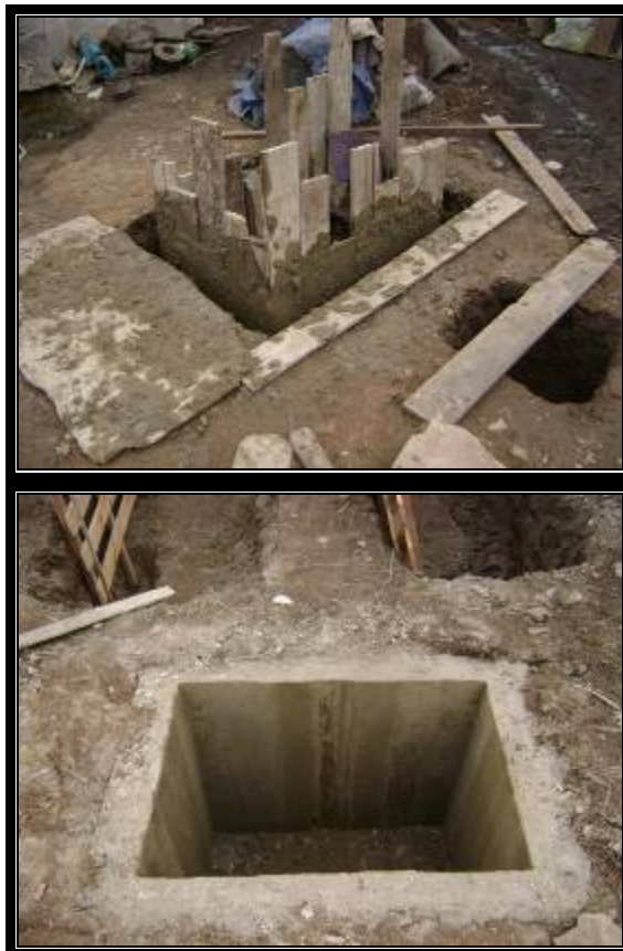
Foto 69 y Foto 70 Se aprecia el encofrado y el tanque sin alisado.
