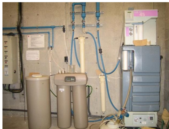
Equipo de desionizado
