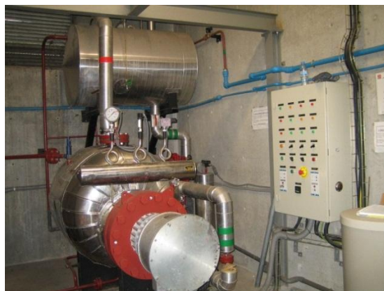
Conjunto de caldera y nodriza
